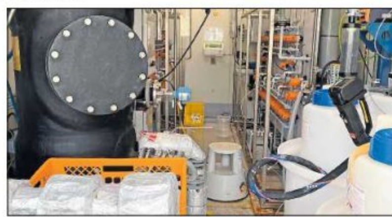
Das Unternehmen Vulcan gewinnt in einer Erprobungsanlage Lithium aus Tiefenwasser. FOTO: BOE
